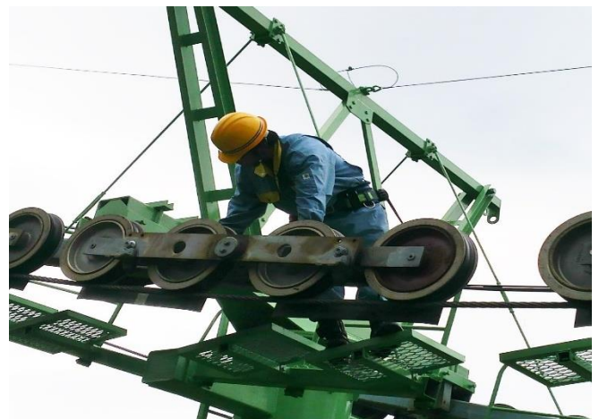
メーカーによる定期点検
